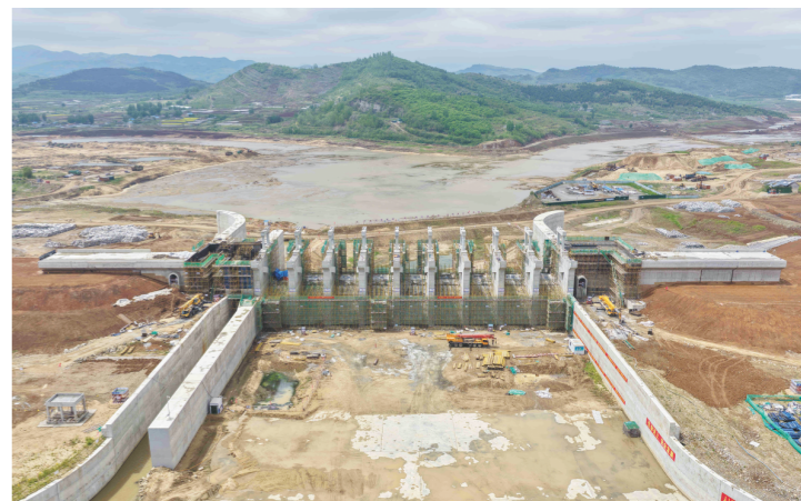
眼下，位于临沂市沂南县的蒙河双坝水库重力坝、泄洪闸、土石坝等关键工程正按节点加速推进。目前，项目累计完成投资超九成，总体形象进度突破82%。图为4月22日拍摄的蒙河双坝水库施工现场。（□新华社发）
