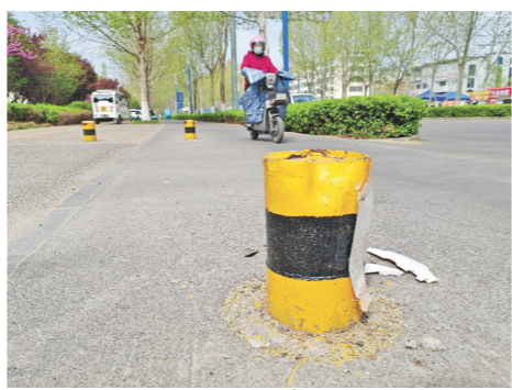
涉事路桩明显破损、变形。
