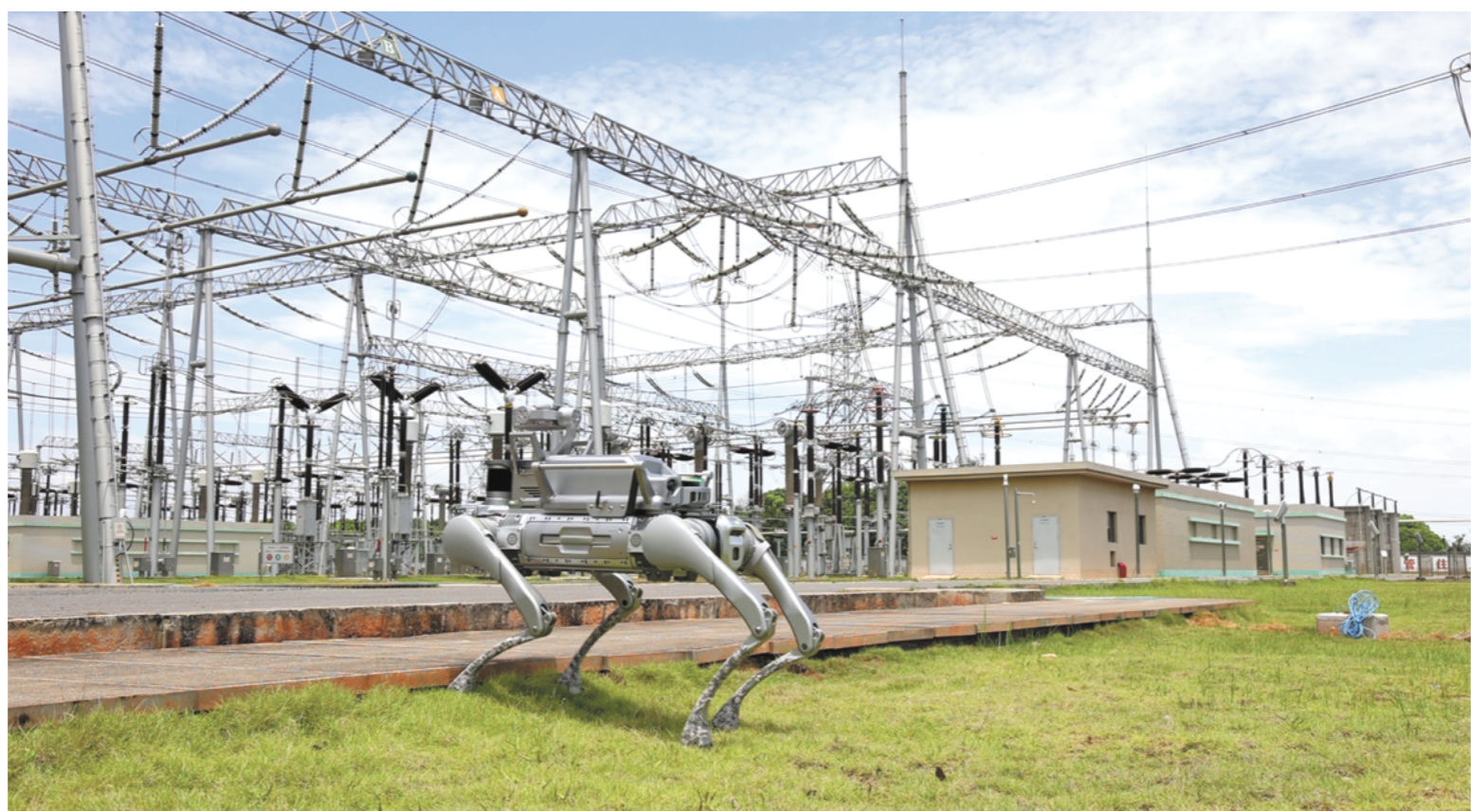
山东柔克智能科技有限公司生产的四足机器人巡检江西永修变电站，护航电网安全。
