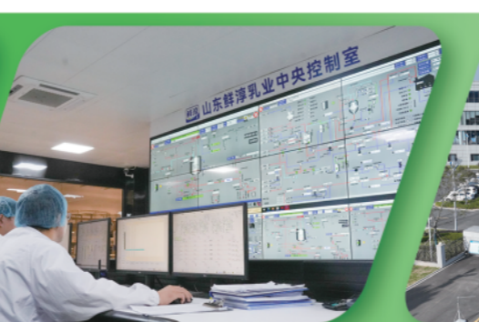
山东鲜淳乳产品加工厂中央控制室
