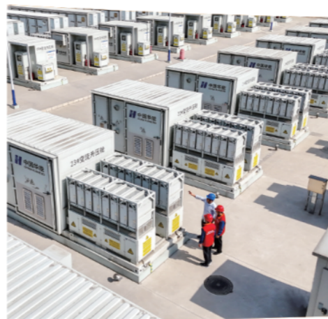
国网山东电力服务新型储能高质量发展
