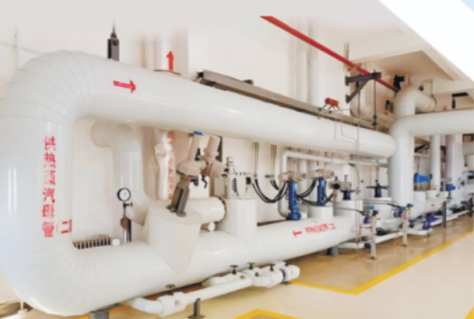
光大环保能源(济南)有限公司改造烟气余热利用设备,为居民住宅提供清洁热源。
