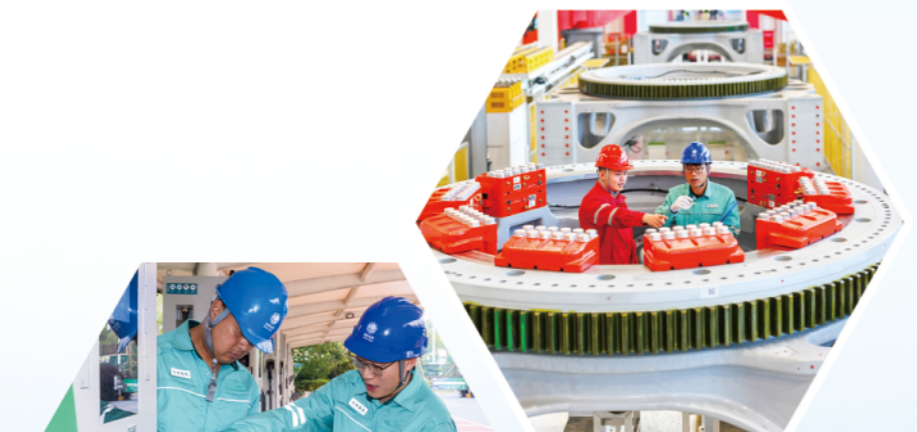
公司工作人员到三一重能（日照）风电设备制造有限公司开展安全用电隐患排查
