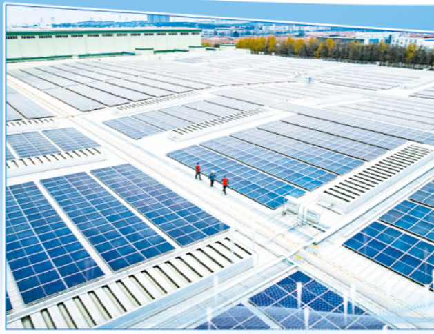
公司工作人员在亚太森博协助检查光伏设备
