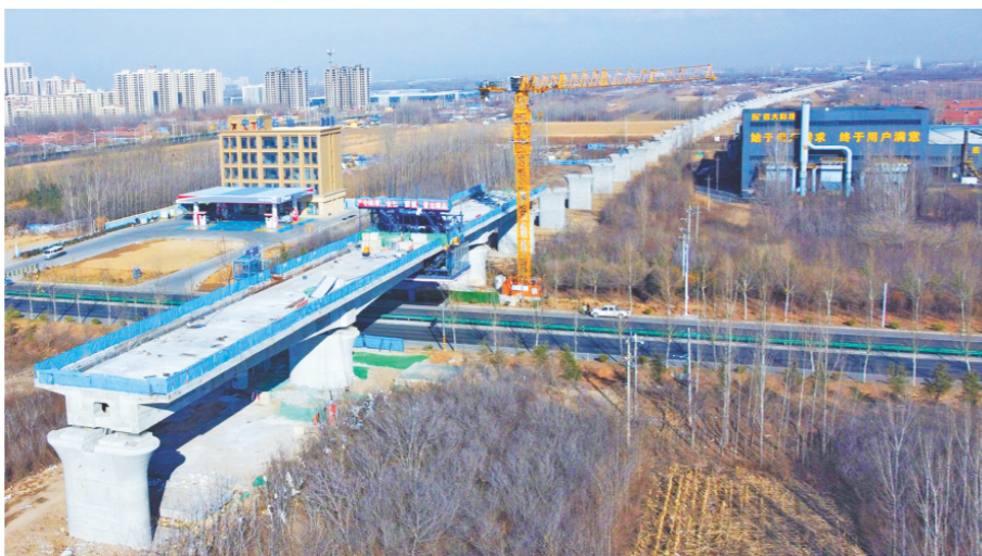
潍宿高铁跨潍坊坊大桥宝通东街（G308国道）连续梁施工现场。
