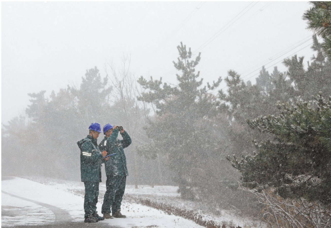
1月18日，国网威海供电公司输电运检人员冒雪对220千伏威正线、威绝线、鮑前钱等7条重要输电线路进行巡检。
