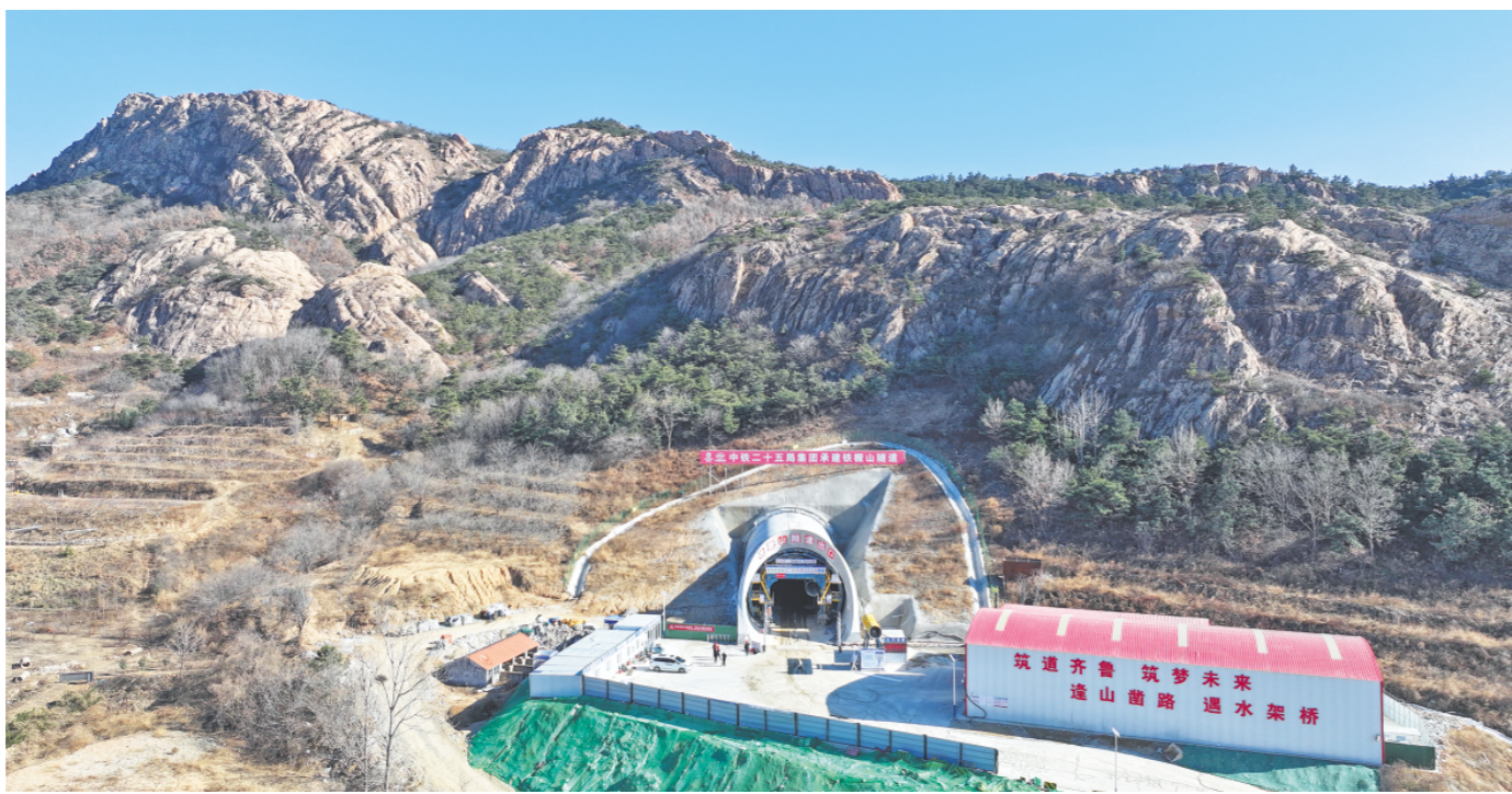
12月22日，潍宿高铁至青岛连接线工程建设迎来新进展，全线首座超千米隧道——铁樵山隧道顺利贯通。据了解，铁樵山隧道全长1292.6米，较预定工期提前80天实现顺利贯通。（□ 记者 白晓 通讯员 苗社 报道）
