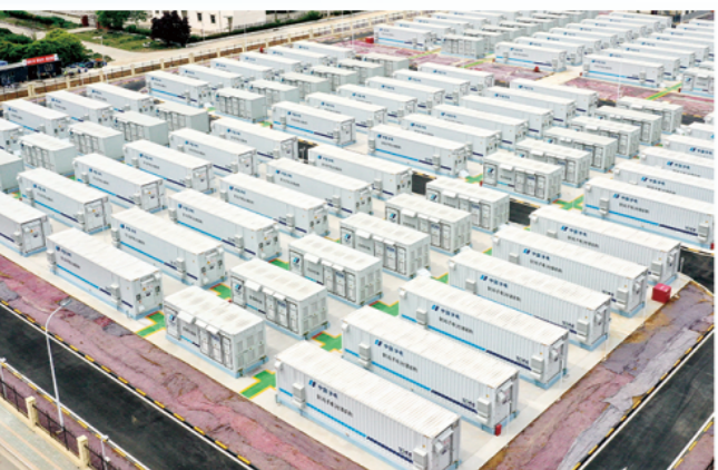
华电滕州101兆瓦/202兆瓦时储能项目
