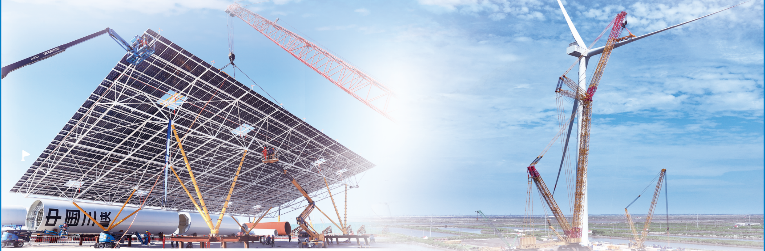
在东营经济技术开发区广利港风电码头，海上光伏平台顺利完成装船作业 摄影：周广学
