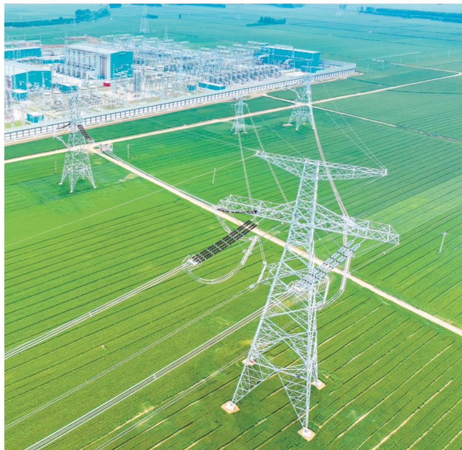
□通讯员 徐可 报道 5月7日拍摄的陇东—山东±800千伏特高压直流工程平换流站。
