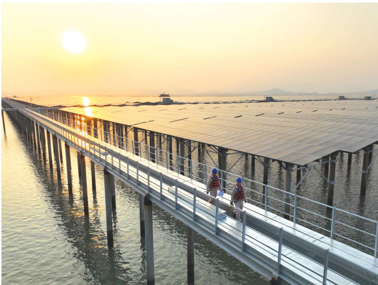
我国首个高风速海域 海上光伏电站项目 全容量并网
