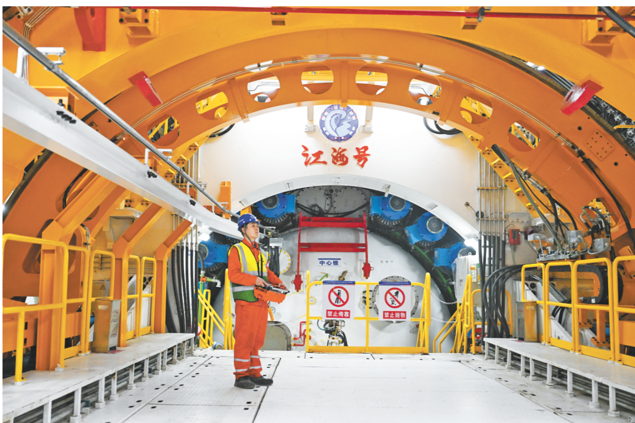
4月9日,中铁十四局工作人员在“江海号”盾构机内进行管片拼装作业。(口新华社发)
