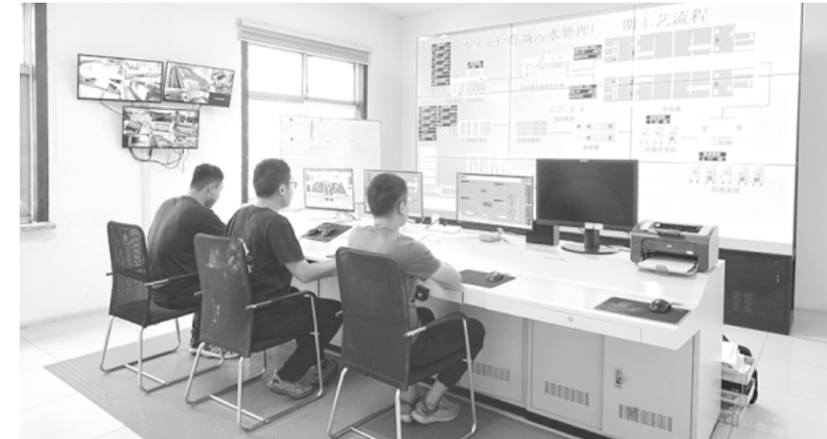
枣庄北控污水处理有限公司中控室数据检测中
