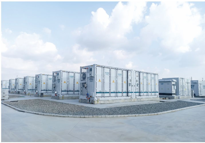
山东电工临邑100兆瓦/200兆瓦时储能电站。
