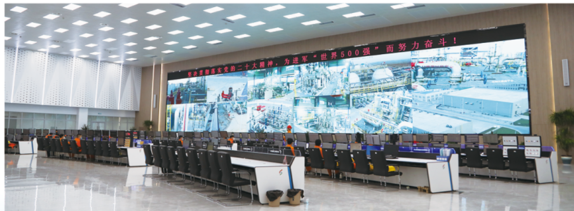
东明石化数字化、智能化中控室
