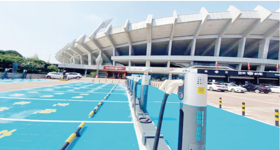
山东省体育中心新动能示范充电站。
